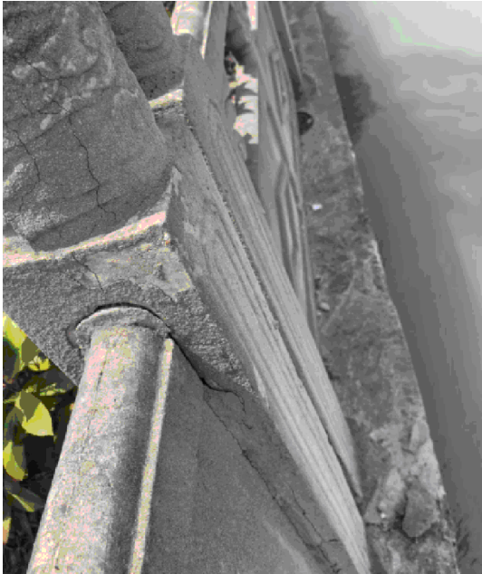
现状仿石栏杆风化、破损
